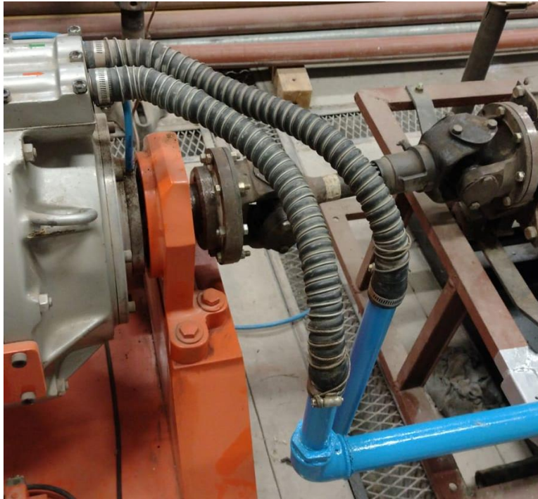
Figura 17. Acople del frenómetro a las cañerías.
