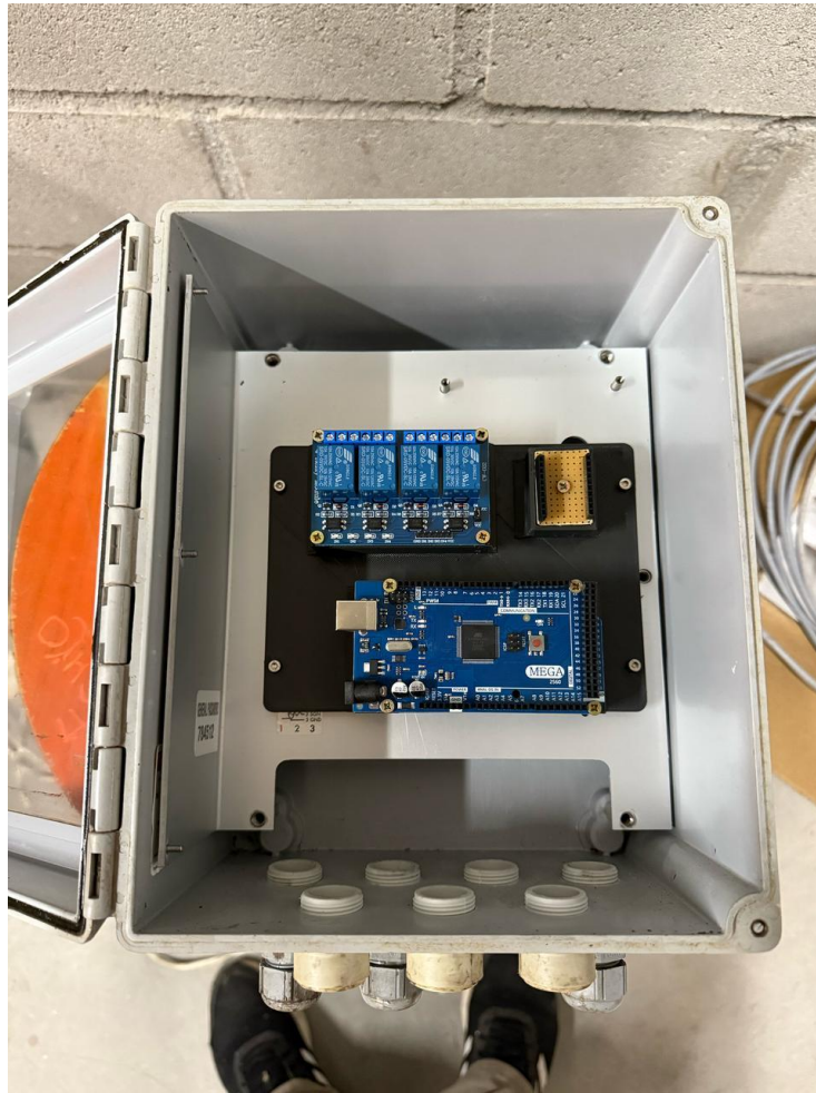
Figura 49. Soporte para Arduino, bornera y módulo relé fijado al gabinete.
