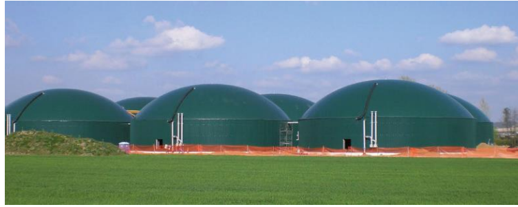
Figura N°16: Gasómetro de doble membrana, en platea de hormigón y sobre biodigestor.
