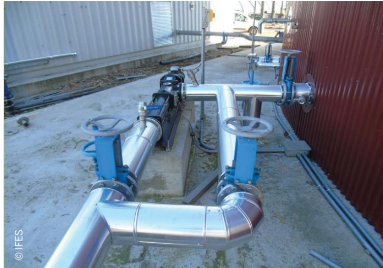
Figura N°32: Bomba a tornillo.
