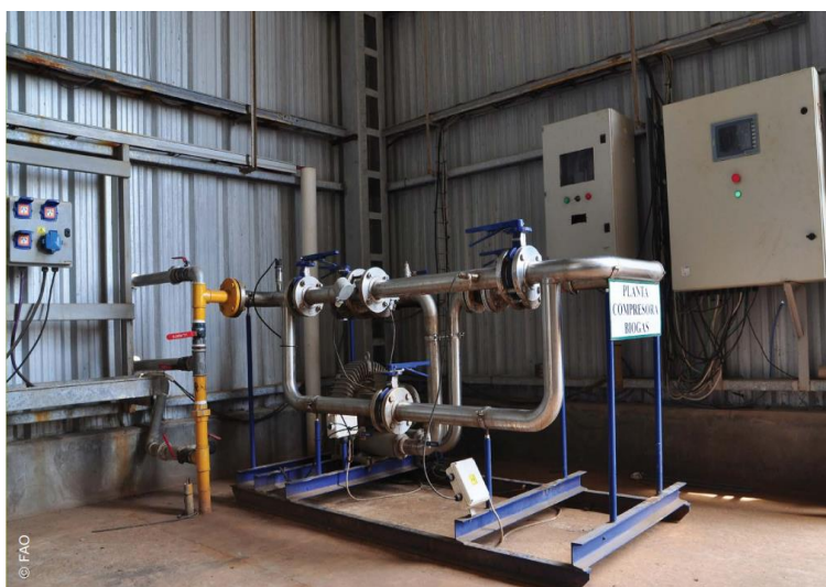
Figura N°18: Soplador de canal lateral y sopladores lobulares.
