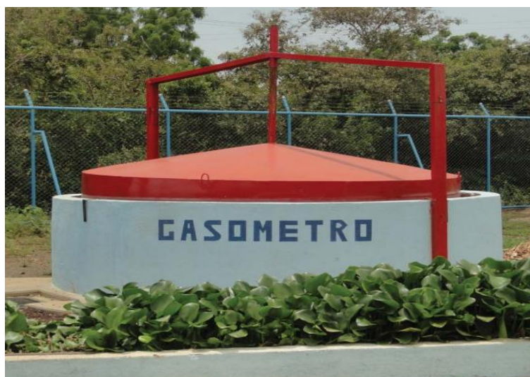
Figura N°15: Gasómetro de campana flotante.
