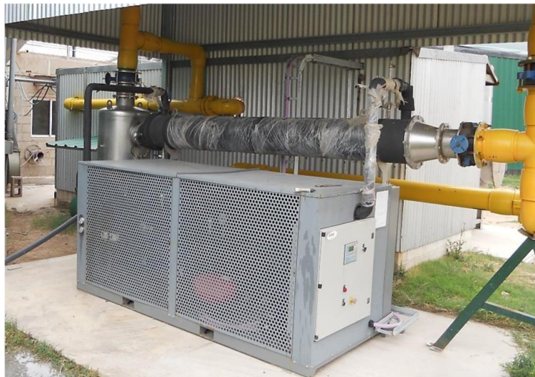
Figura N°12: Sistema chiller/enfriamiento para secado del biogás.
