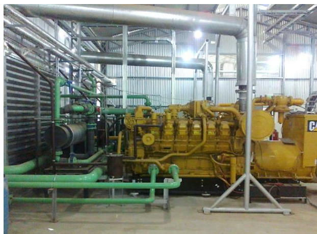
Figura N°21: Motor Biogás-Otto instalado en central de biogás.
