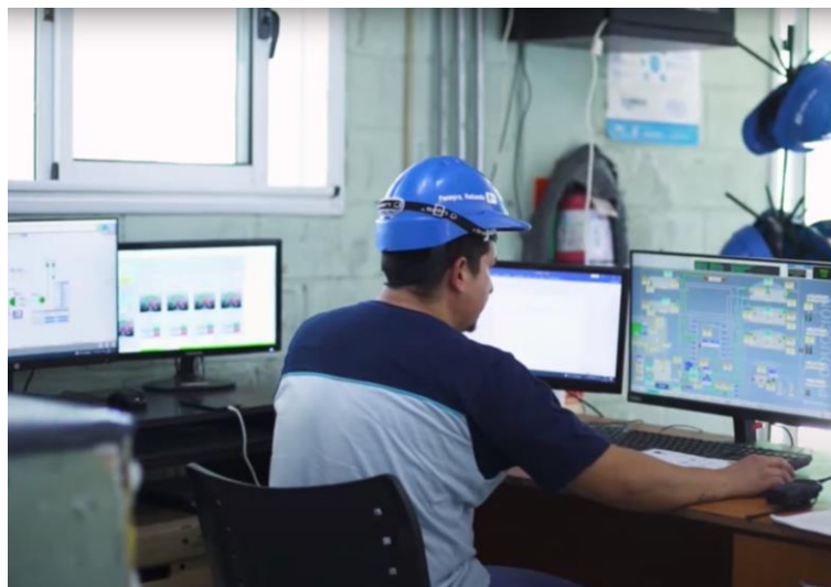
Figura 40: Sala de control.
