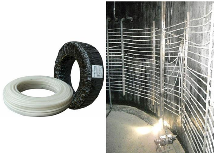
Figura 34: Forma de sistema de calefacción, tubería de polietileno.
