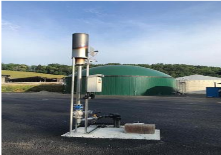
Figura 47: Quemador, componente de seguridad.
