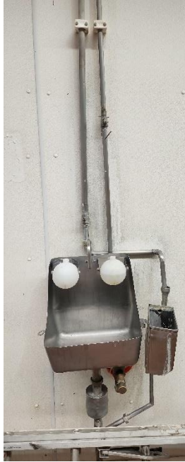
Figura 19. Esterilizador de cuchillos y lavamanos
