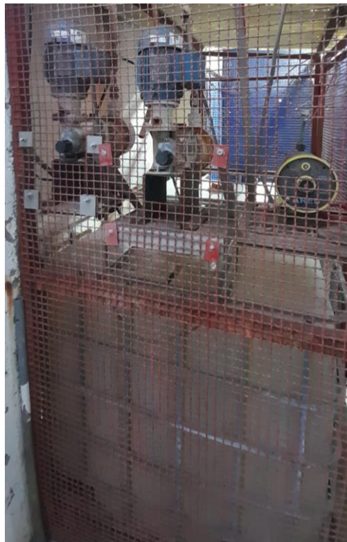
Figura 22. Dosificación de cloro a cisterna
