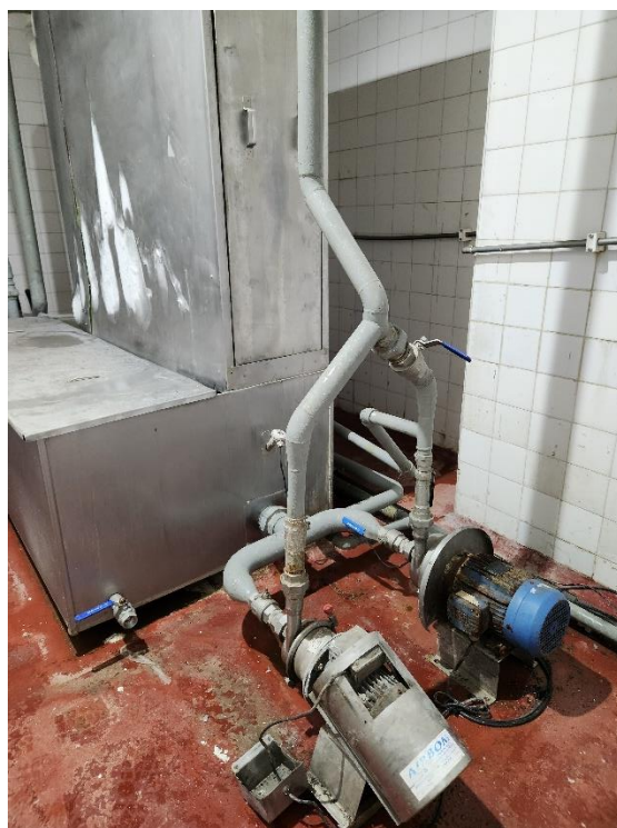
Figura 14. Manipulación del agua mediante válvulas y bombas
