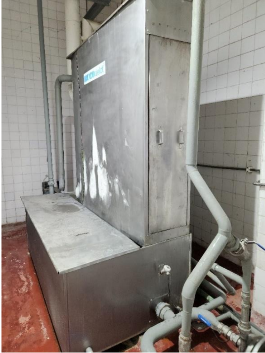
Figura 12. Equipo enfriador de agua
