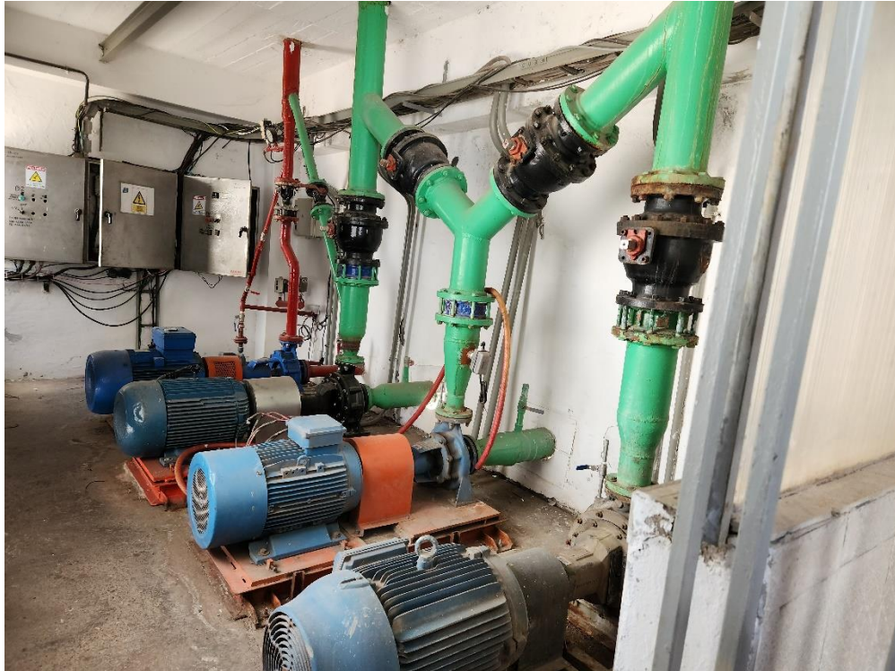
Figura 9. Sistema de bombeo hacia tanque elevado
