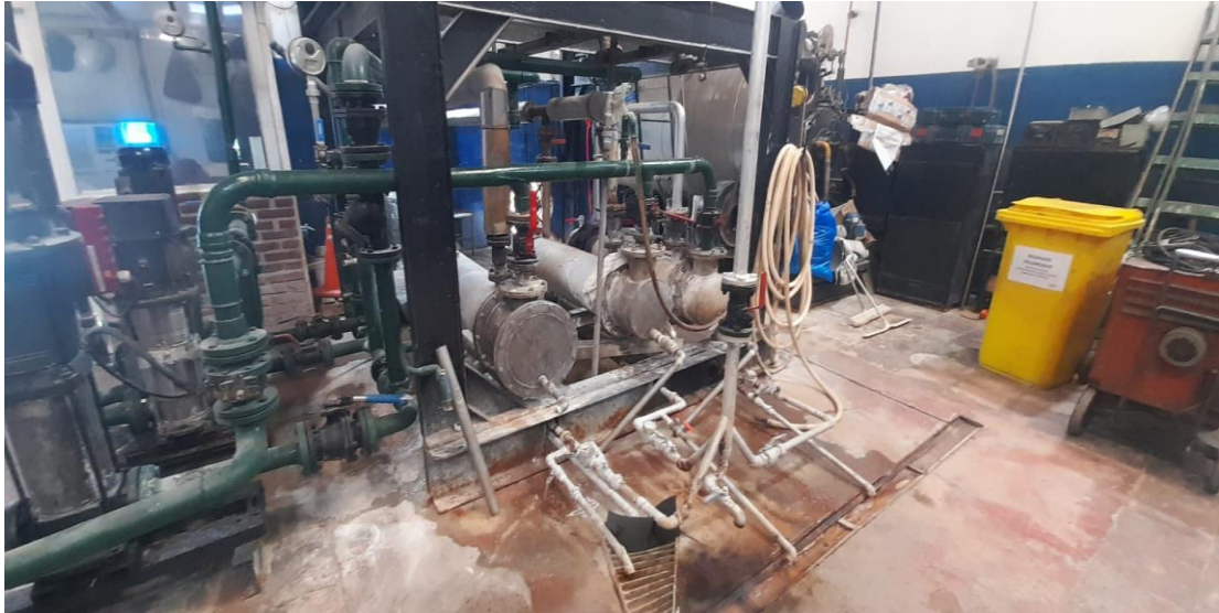
Figura 16. Intercambiadores de cascos y tubos
