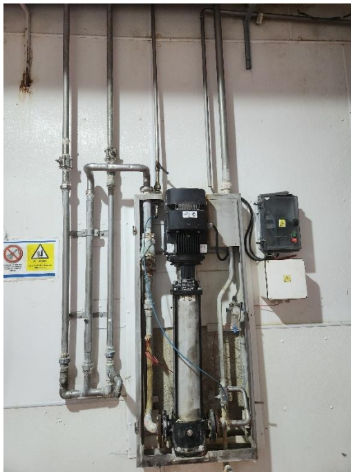
Figura 18. Bomba de limpieza
