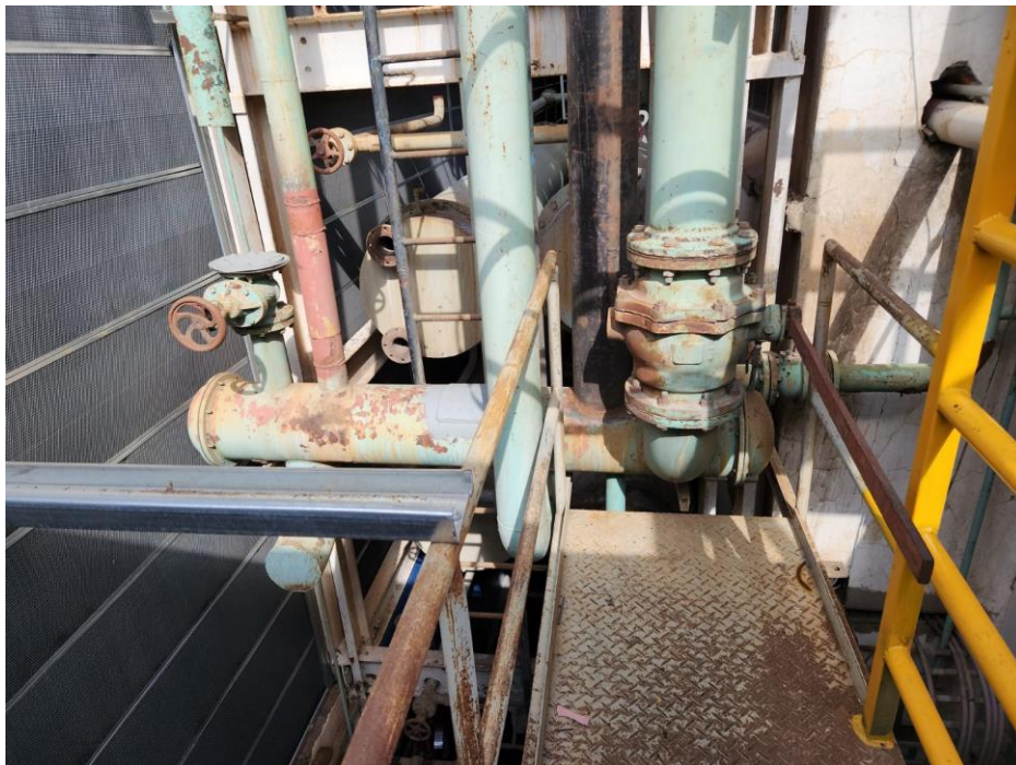
Figura 7. Colector de agua de pozos
