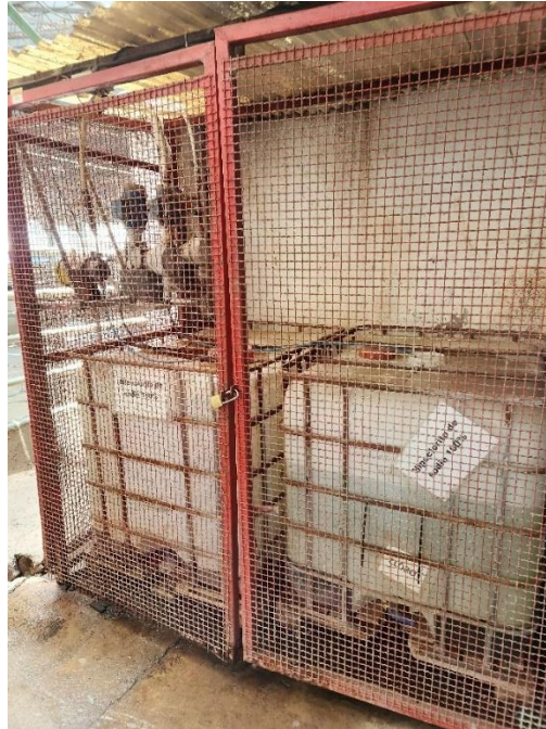
Figura 20. Bombas de diafragma y depósitos de cloro
