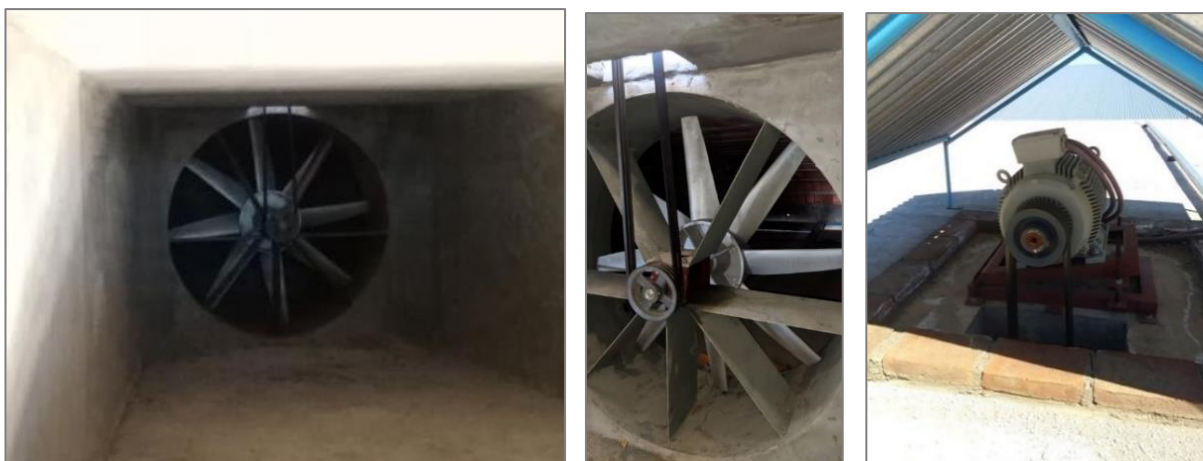
Figura 38. Conjunto motor-ventilador de un horno de secado. Imagen proporcionada por la empresa.
