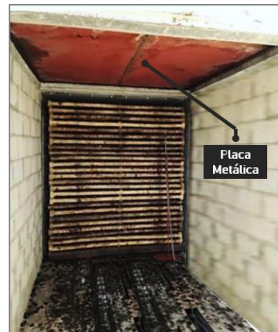
Figura 94. Fotografía de la placa metálica utilizada para el bloqueo del aire de recirculación.
