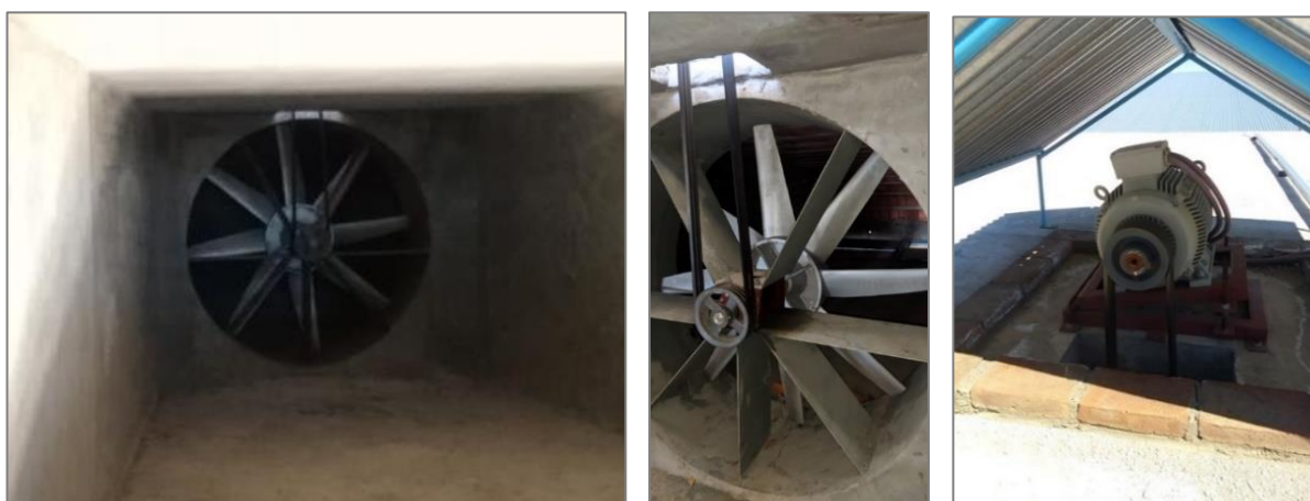
Figura 38. Conjunto motor-ventilador de un horno de secado. Imagen proporcionada por la empresa.
