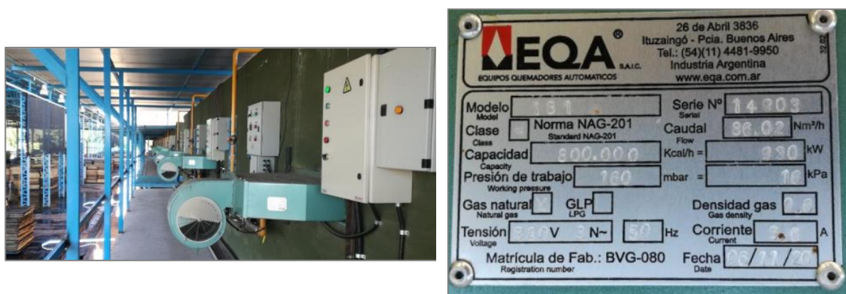
Figura 34. Vista de hornos a nivel de quemadores, junto con placa característica de los mismos. Imagen proporcionada por la empresa.
