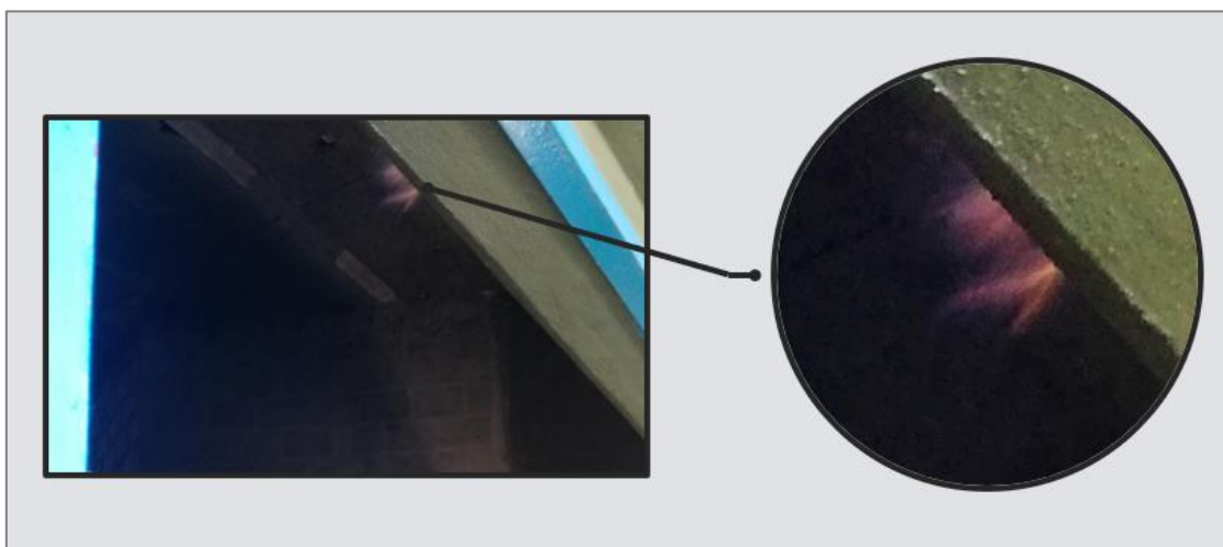
Figura 51. Imagen de la llama que proporciona el quemador dentro del túnel superior del secador.
