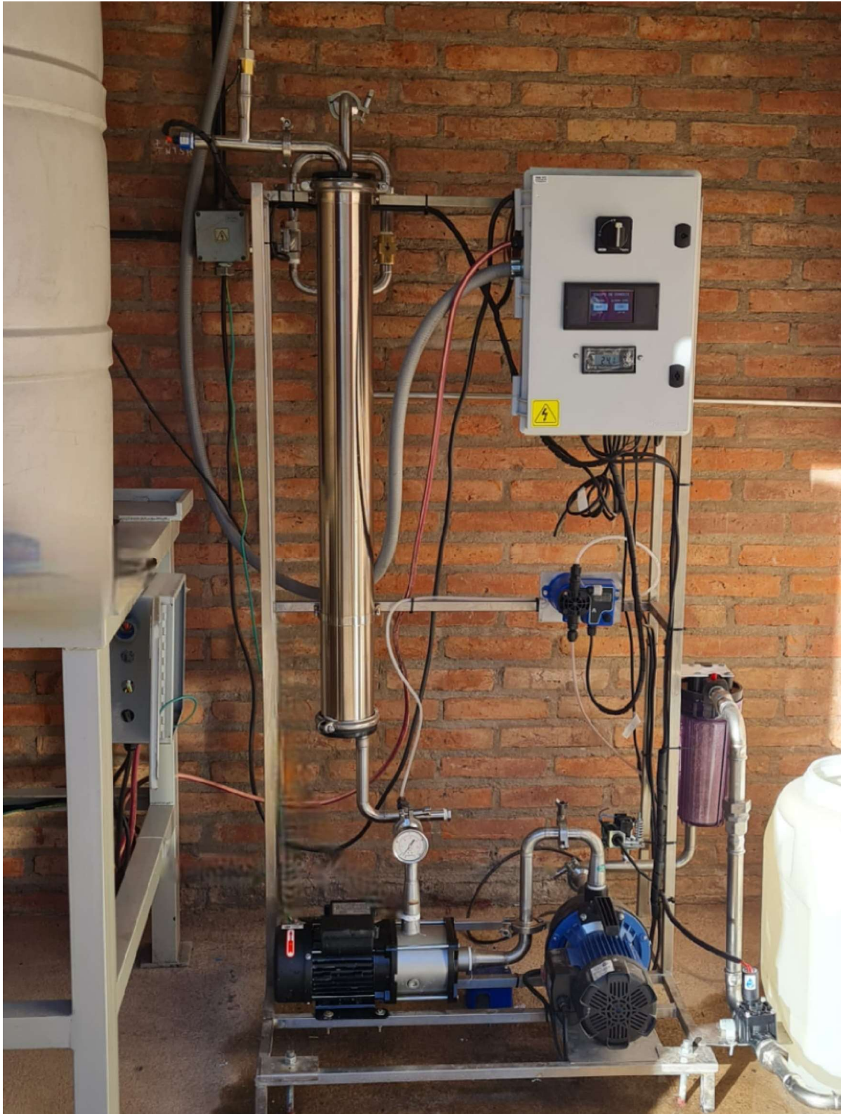
Figura N° 35: Equipo de osmosis - implementación real
