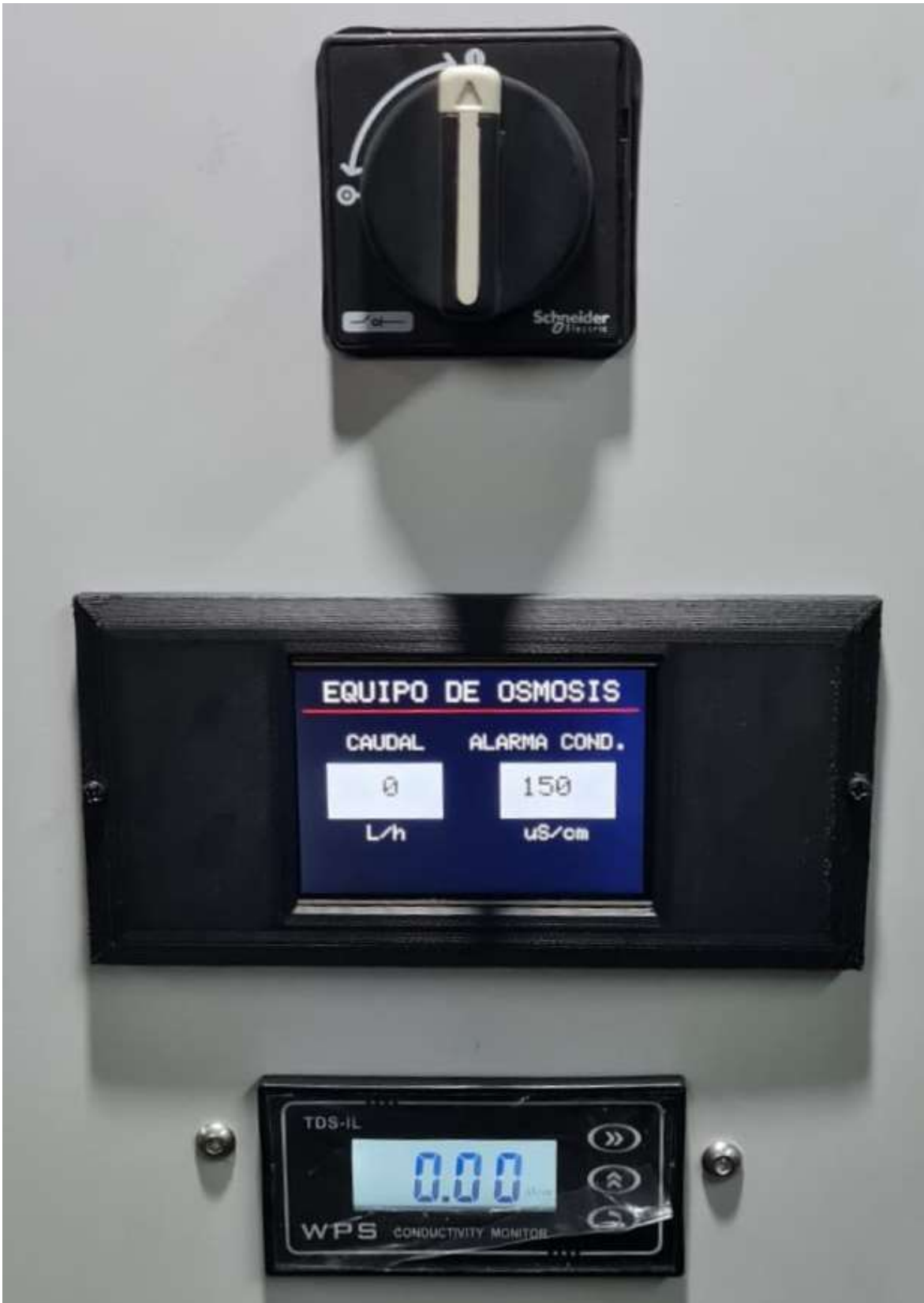
Figura N° 37: PLC open source - implementación real
